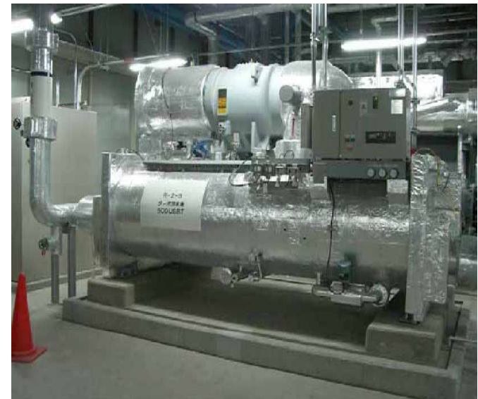
高効率型ターボ式冷凍機 (大館工場)
