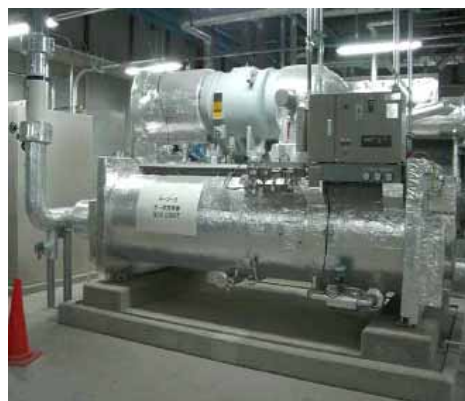
高効率型ターボ式冷凍機(大館工場)
