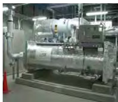
高効率型ターボ式冷凍機(大館工場)
